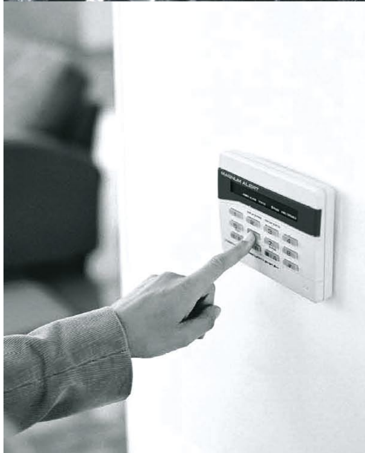
Le digicode a remplacé les serrures
